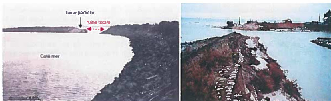
Figure 2-2: Exemple de rupture dans une digue maritime (Source : CCIN)
