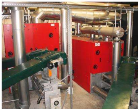
Chaudières de 850 kW et de 275 kW
