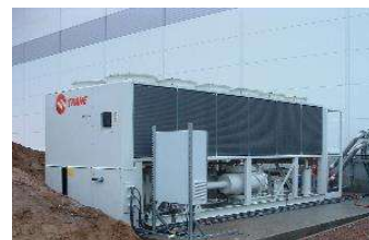
Groupes froids équipés d'échangeurs pour récupérer la chaleur
