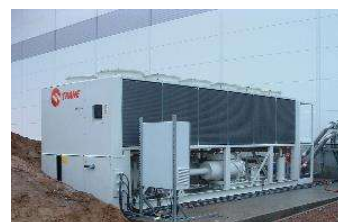
Groupes froids équipés d'échangeurs pour récupérer la chaleur
